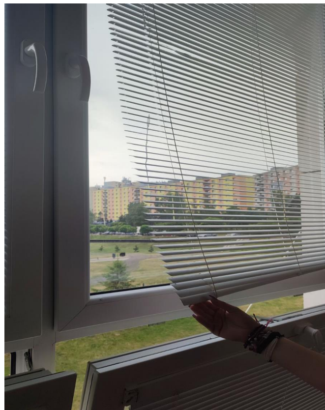
- Poškodené žalúzie na oknách
