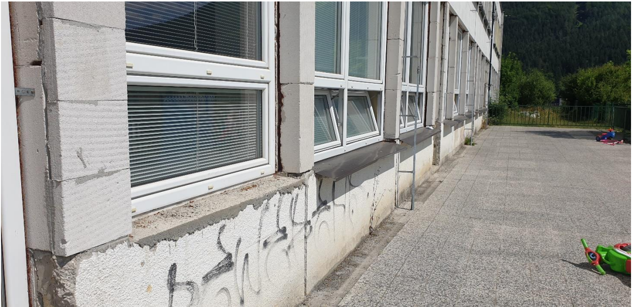
- Poškodené parapety na oknách
