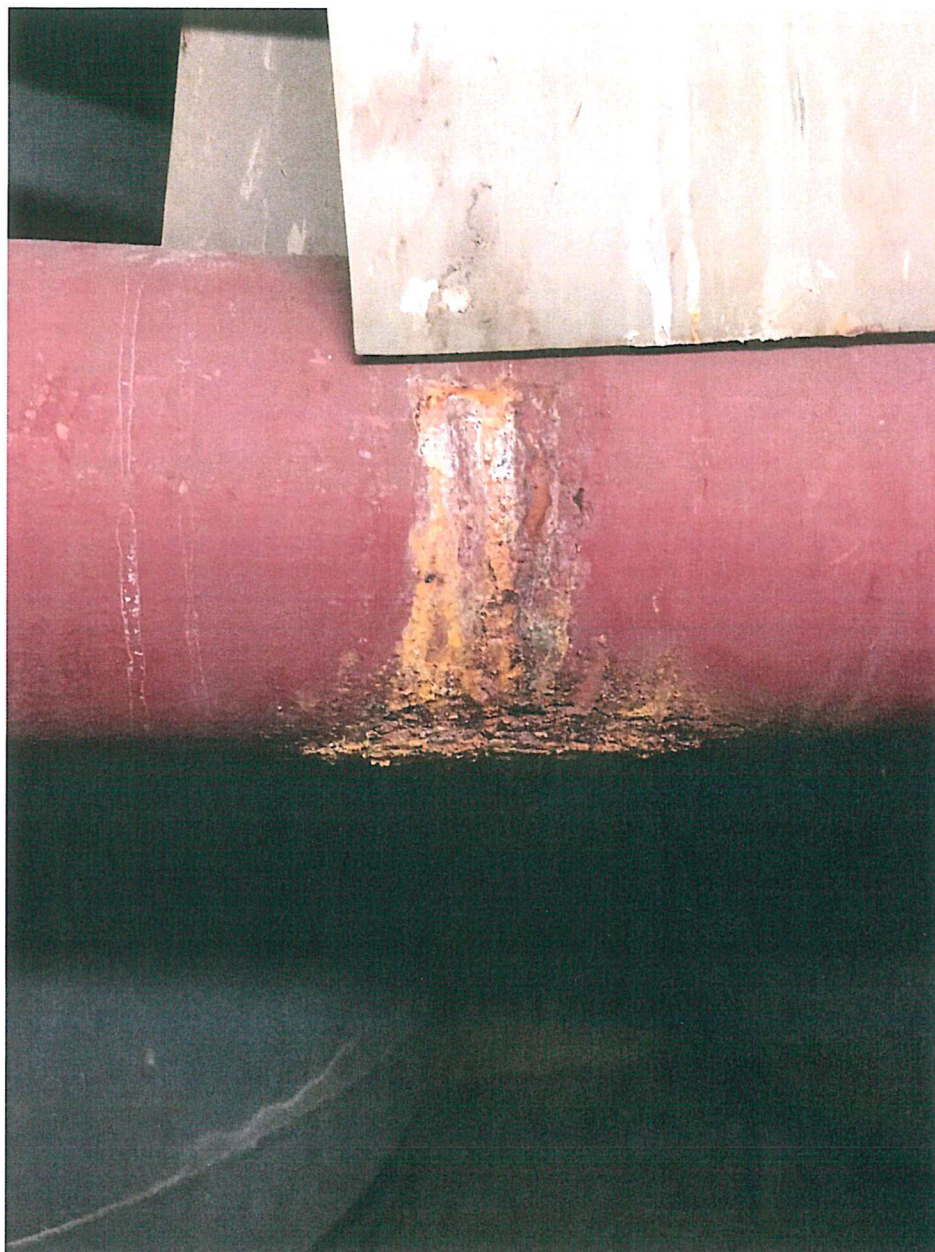
Obr. č.6: Časť ocelového potrubia s priesakom vody
