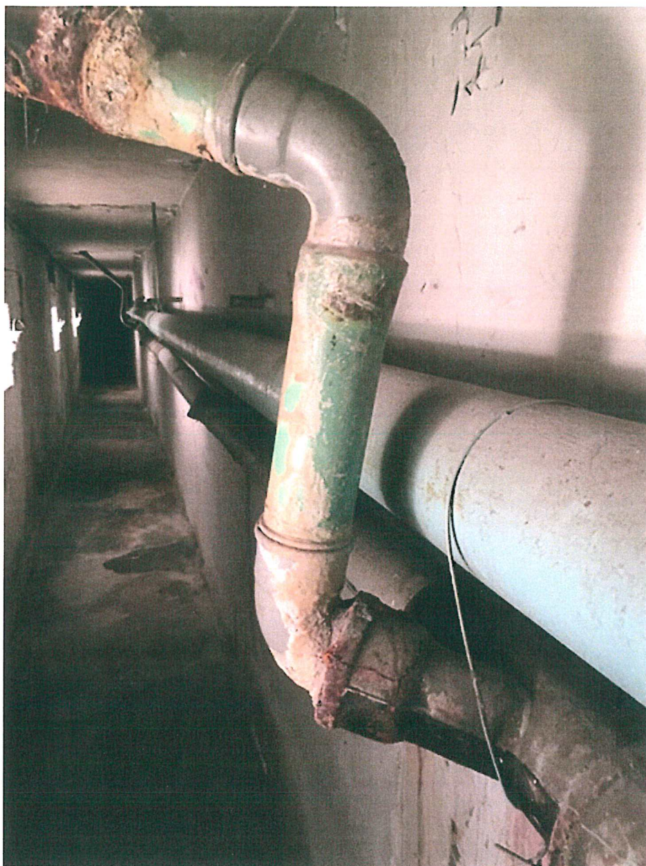
Obr. č.7: Poškodené rozvody kanalizácie v suteréne
