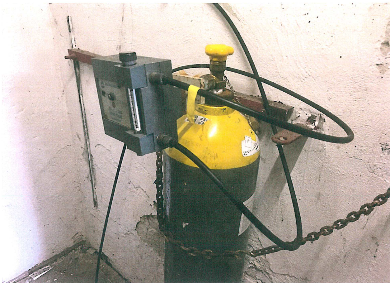
Obr. č.2: Manuálne chlórovanie plynným chlórom
