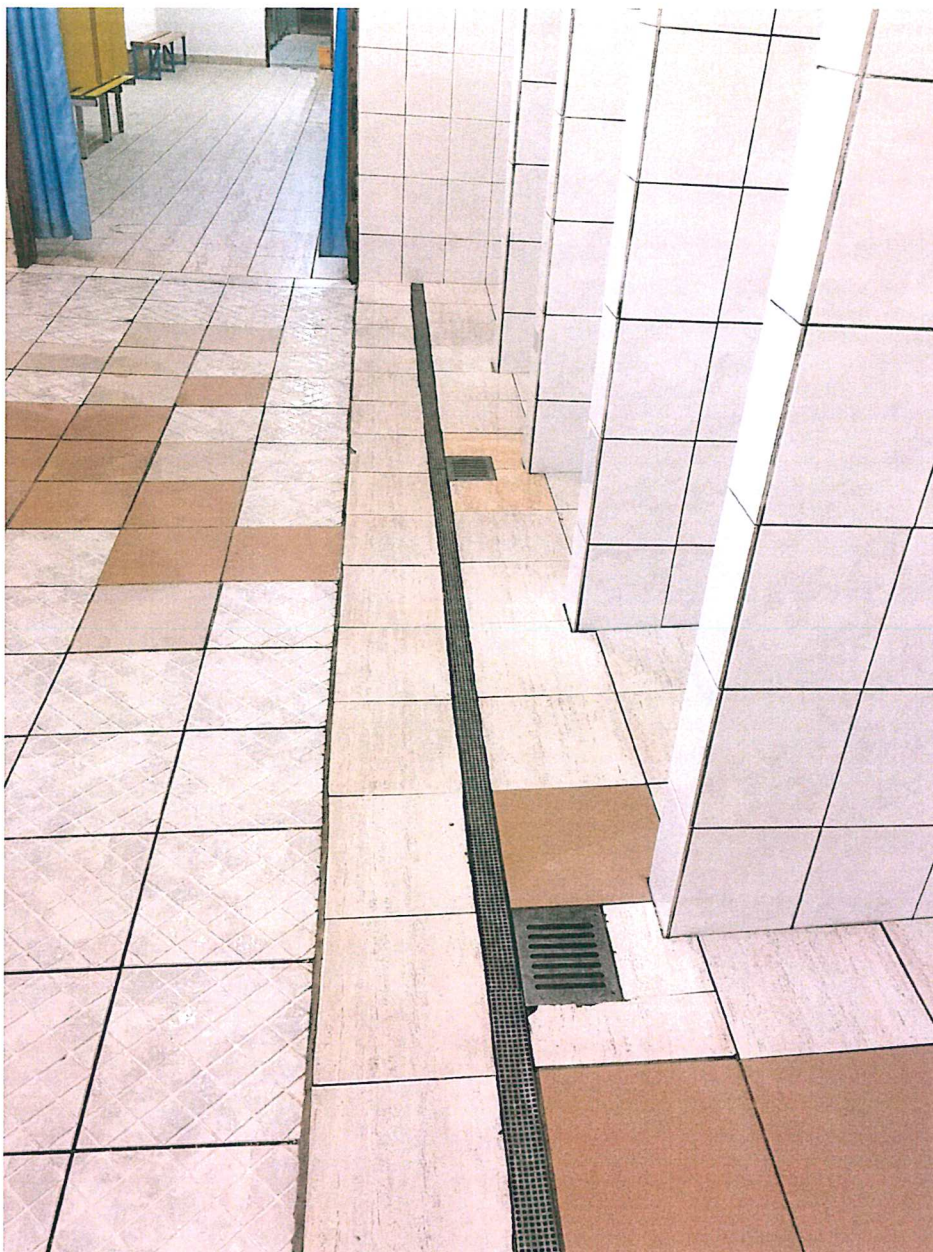
Obr. č. 8: Nefunkčné odvodnenie plôch a sprích,
