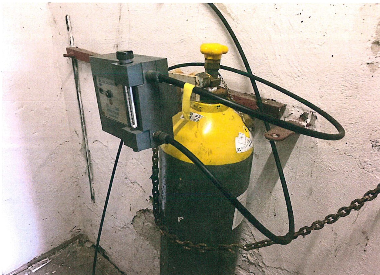
Obr. č.2: Manuálne chlórovanie plynným chlóróm
