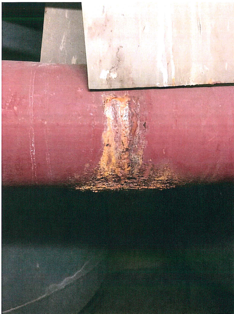
Obr. č.6: Časť oceleového potrubia s priesakom vody
