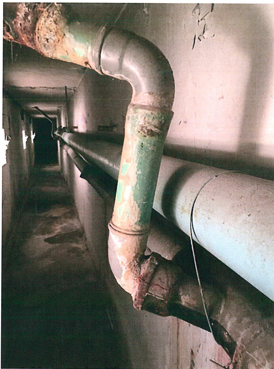
Obr. č.7: Poškodené rozvody kanalizácie v suteréne
