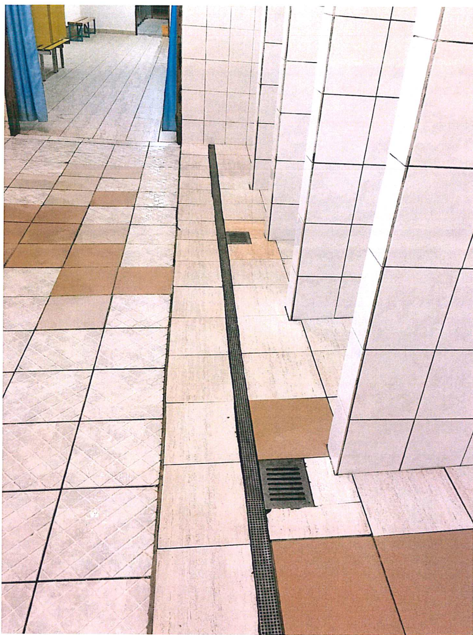
Obr. č. 8: Nefunkčné odvodnenie plôch a sprích,
