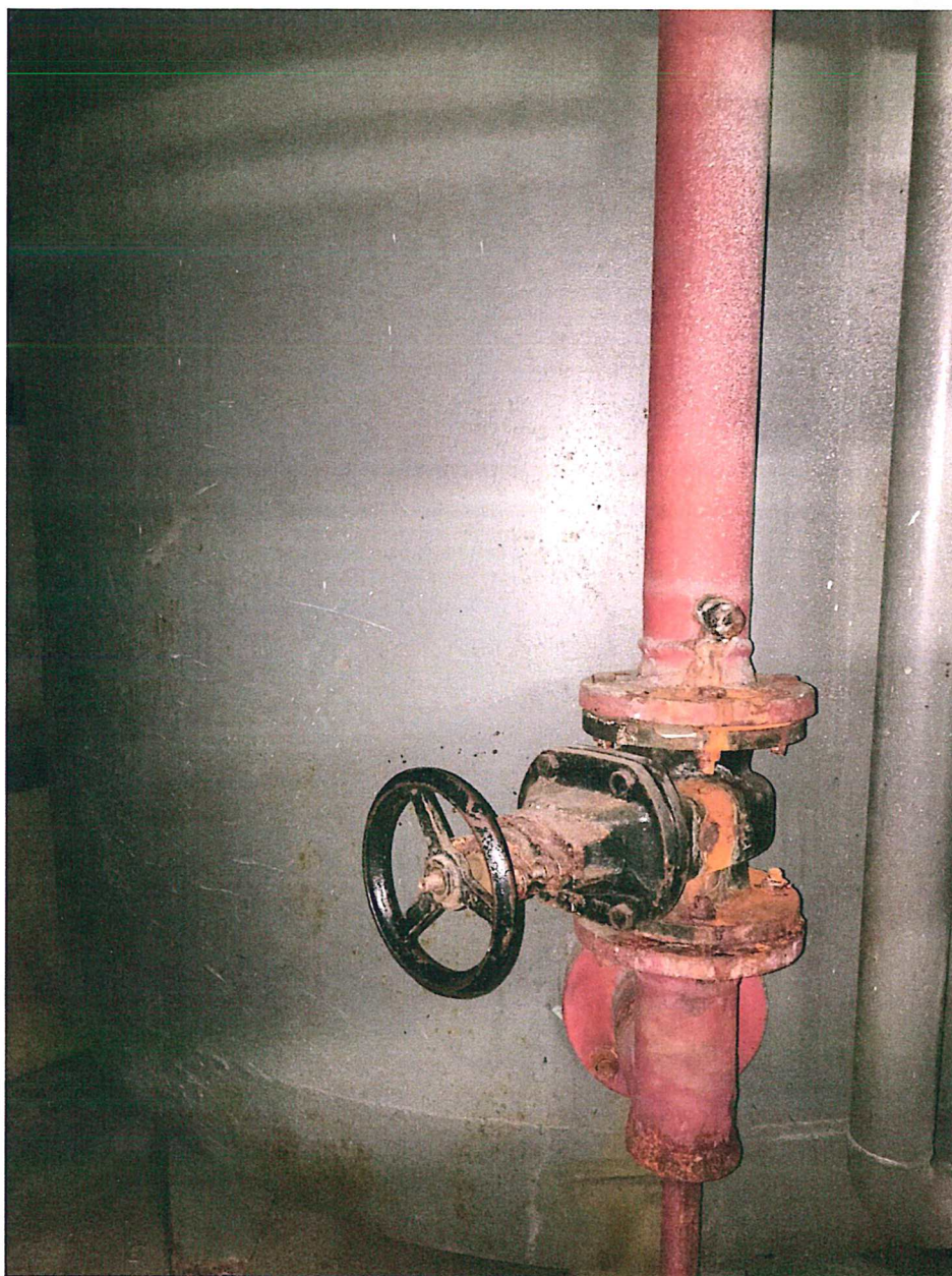
Obr. č.5: Úsek ocelového potrubia zrelý na výmenu
