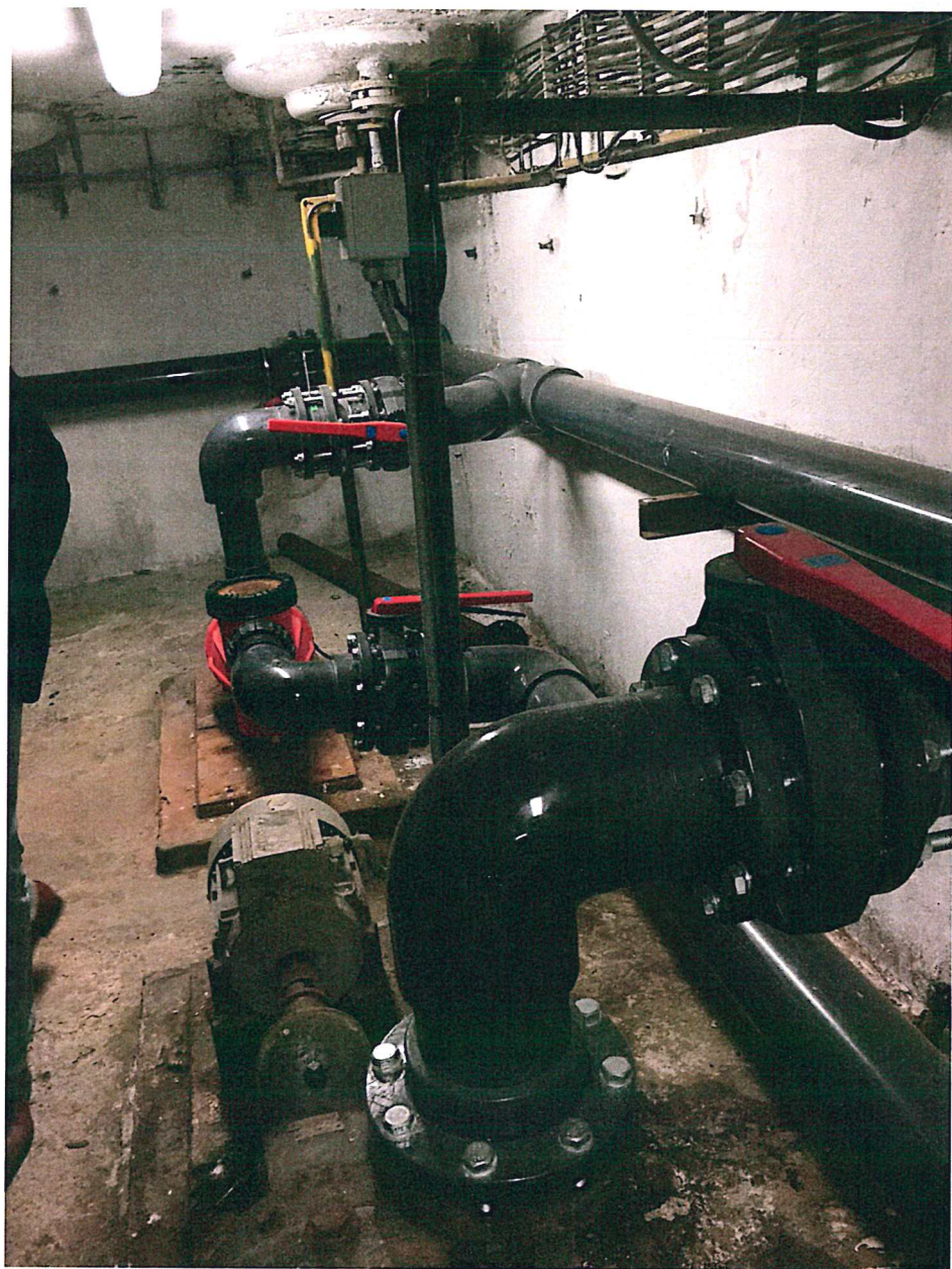
Obr. č.4: Niektoré kriticky poškodené potrubia už boli vymenené
