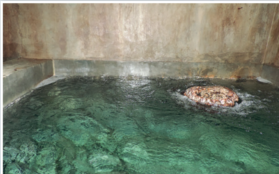
Vodárenský objekt – Vodný zdroj Teplô
