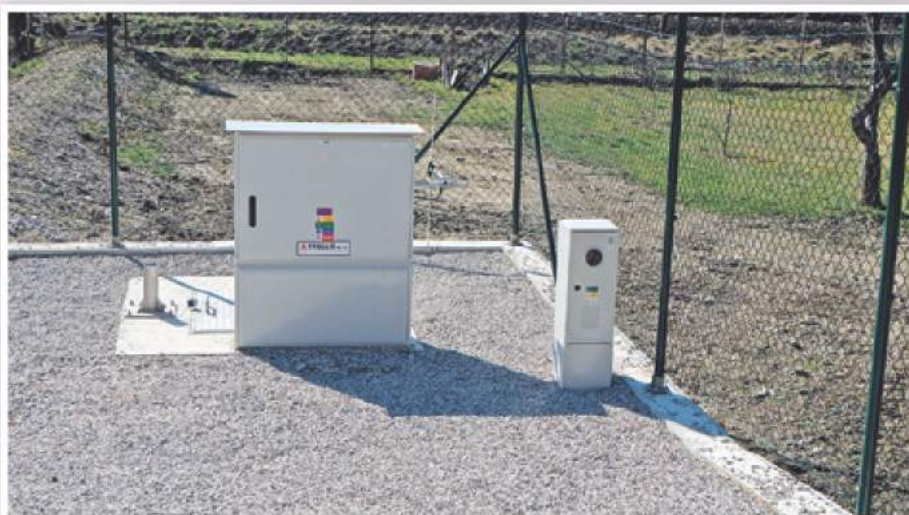
Čerpacia stanica odpadových vôd
