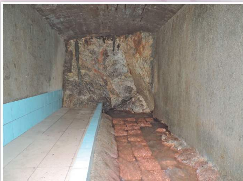
Vodárenský objekt – vodný zdroj Pod Javorom
