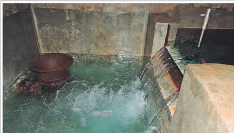
Vodárenský objekt – Vodný zdroj Teplô
