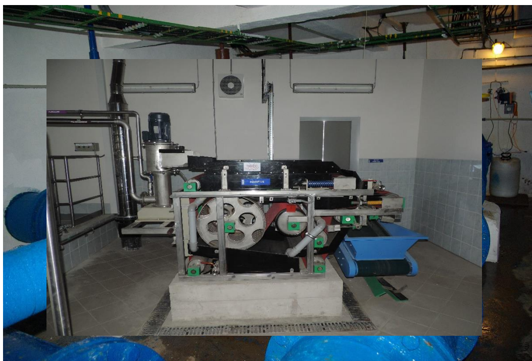
Obr. Vodárenský objekt vodojem Kosovo – armatúrna komora
