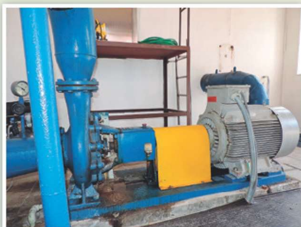
Vodárenský objekt – MVE Liptovská Osada
