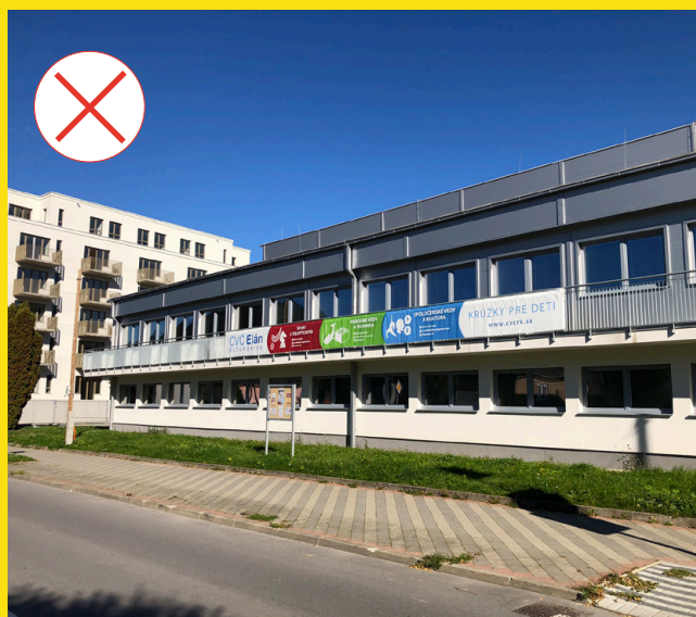
Plavisko - zlý príklad umiestnenia reklamného zariadenia na zábradlí rekonštruovanej šport. budovy
