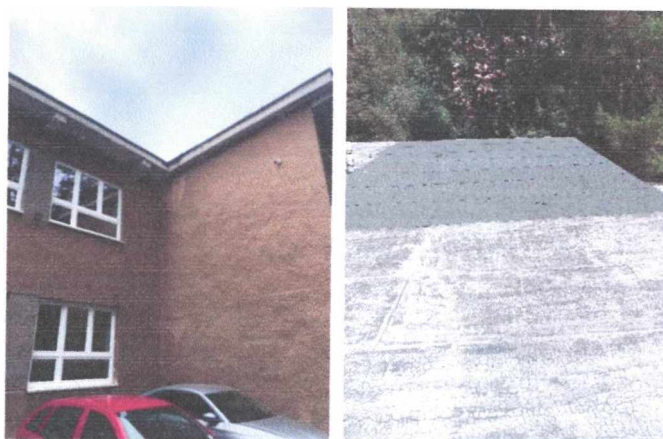
poškodenie strešnej krytiny, detail
